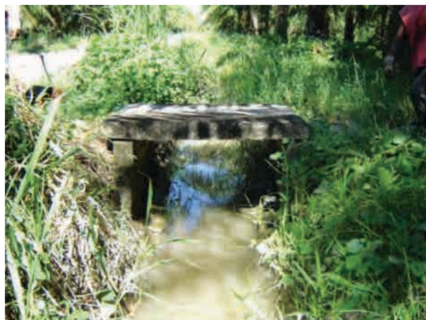
Figura 79. Canales parcialmente limpios.
