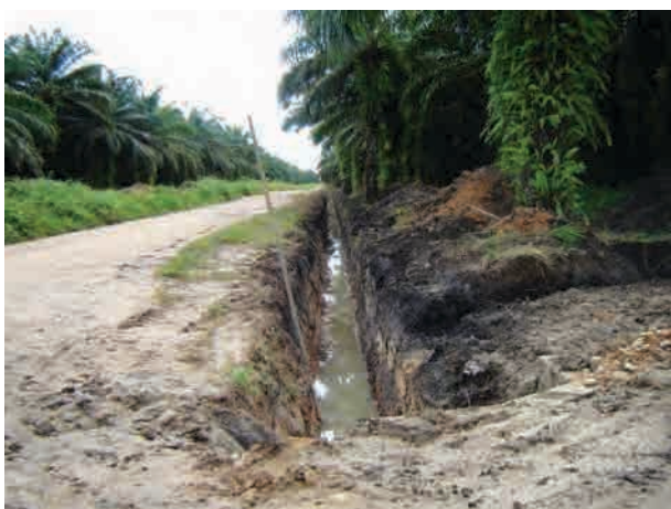
Figura 27. Drenaje funcional en un borde de lote.
