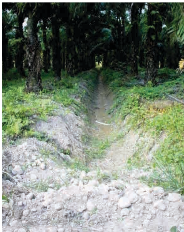
Figura 76. Canales de drenaje limpios.
