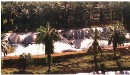
Laguna carpada para colectar biogás
