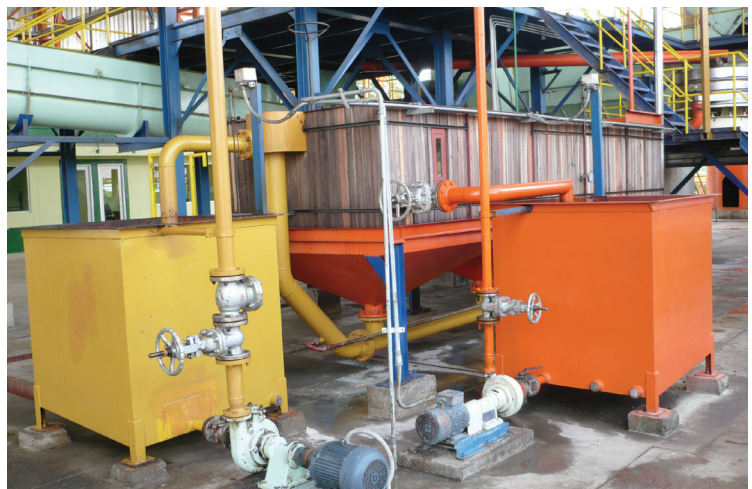
Preclarificador y tanques auxiliares
