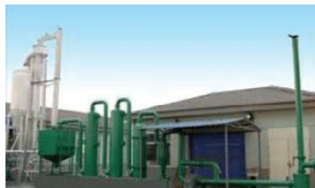
Gasificador y limpieza de biogás
