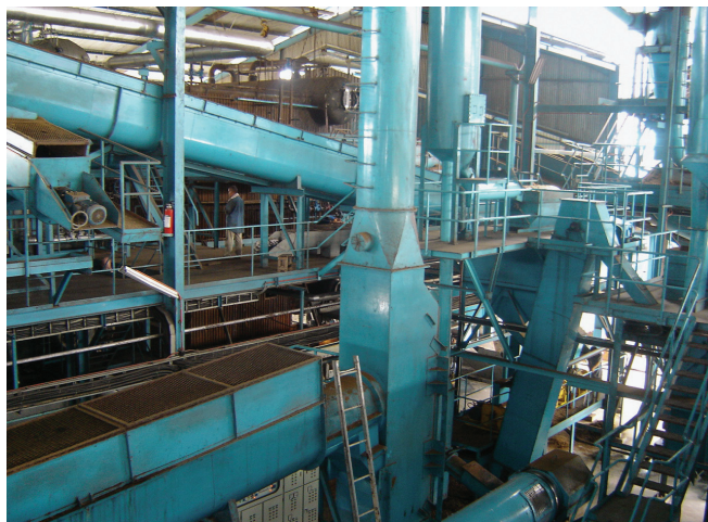
Vista general del sistema de recuperación de almendra
