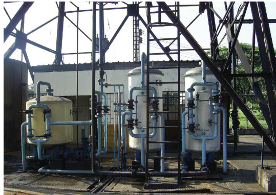
Sistema de tratamiento de agua para proceso y calderas
