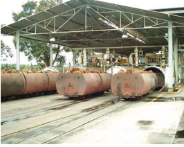
Sistemas de alimentación en autoclaves
