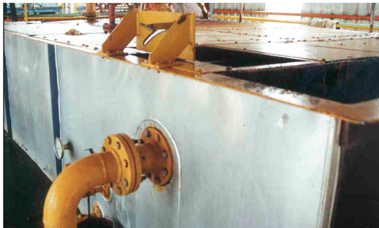
Control manual de la capa de aceite en un clarificador horizontal
