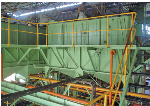
Derecha. Clarificador vertical
