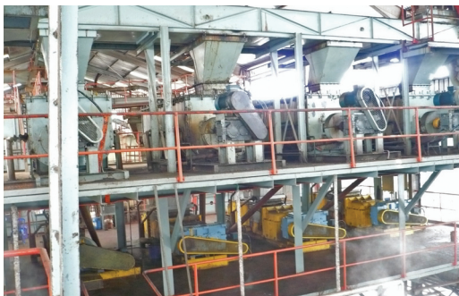
Izquierda. Sistema de prensado con digestores horizontales
