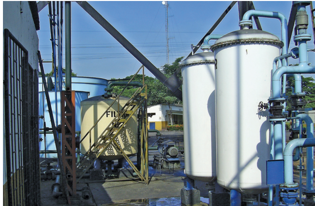
Filtros y suavizadores de un sistema de tratamiento de aguas
