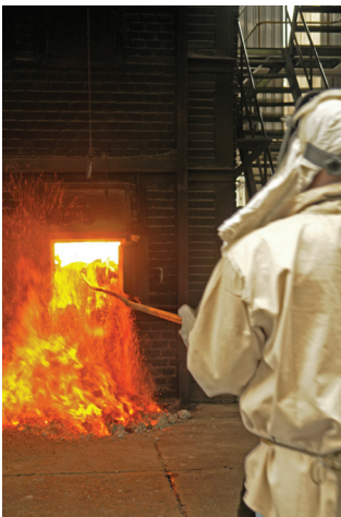
Vista frontal de una caldera
