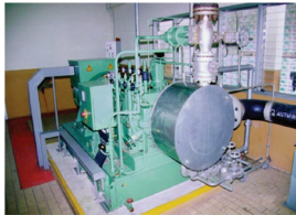
Generación de energía
