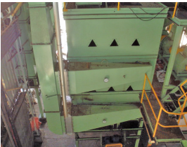
Silo de secado de almendra
