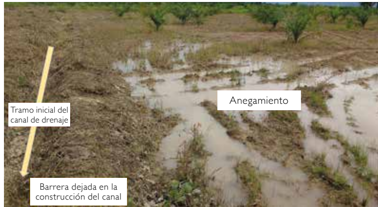
Figura 12. Favorecimiento de encharcamiento por disposición inadecuada de suelo removido al momento de la construcción de un canal de drenaje, que actúa como barrera al movimiento superficial del agua.
