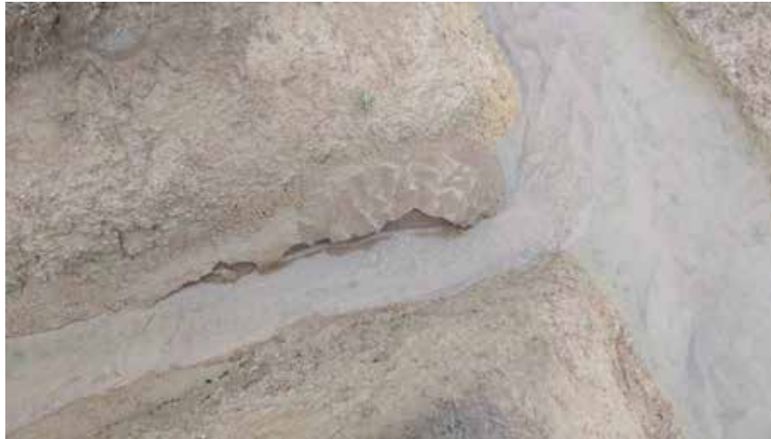
Figura 31. Acumulación y arrastre de sedimentos en canales de drenaje.
