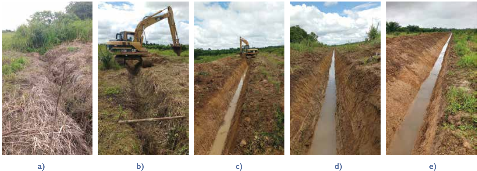
Figura 41. Mantenimiento correctivo del canal secundario de drenaje. (a) Gran cantidad de maleza en el canal (b) Inicio de intervención con pala excavadora (c) Inicio de flujo de agua durante la intervención del canal (d) Canal de drenaje intervenido y con funcionalidad recuperada. (e) Condición del canal de drenaje después de una semana de intervenido.
